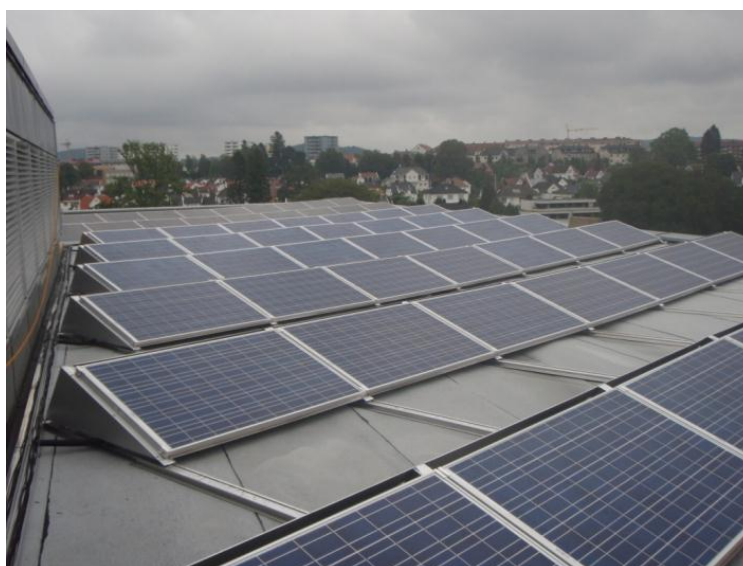
Figur 4: Solcelleanlegget på taket til Agder Energi sitt hovedkontor [Multiconsult]
