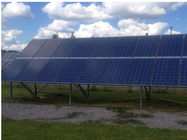
Figur 5: Solcelleanlegget ved Glava Energy Center, Sverige [Multiconsult]
