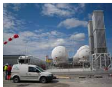
Naturgass Møre sitt LNG-anlegg i Bingsa ved Ålesund ble satt i drift i 2010. Det nye anlegget består av i alt 2 LNG-tanker à 680 m 3 og leverer gass til kunder på Sunnmøre.
