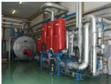
Mosseporten næringspark har bygd opp et omfattende energiprojekt. En utbygd fjellhall leies ut som frysehotell for Findus sitt hovedlager for matvarer. Lokalt produsert biogass omdannes til elektrisitet og varme i et biokraftverk. Overskuddsvarmen og damp utnyttes til fjernvarme og industri. Anlegget leverer vel 9 GWh frysekapasitet, 8,5 GWh fjernvarme/damp og 8,5 GWh elektrisitet.
