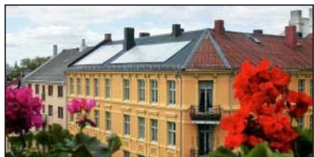
Solfangere er installert på dette taket i Sverdrups gate i Oslo. (Foto: Aftenposten)
