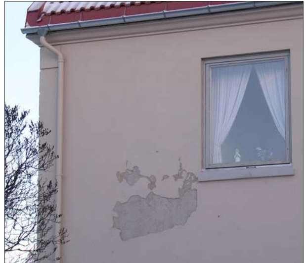
Avskallet puss på gammel teglsteinsmur. Etterisolering på innsiden av veggen kan gi frostskafer. (Foto: K. Hermstad)
