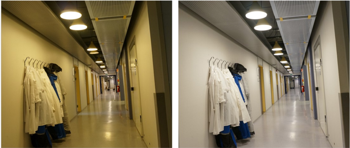
Korridorbelysning ved MH-bygget før og etter utskifting. Foto: Bjørn Blix.
